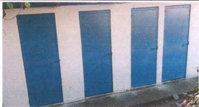
Foto 3: Sustrucción de puertas en servicios sanitarios
